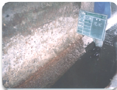
施工前 (劣化状況)
