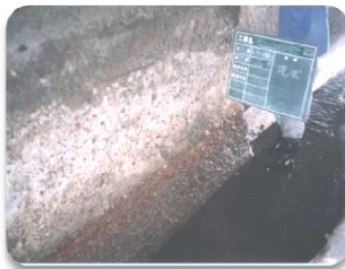
施工前 (劣化状況)
