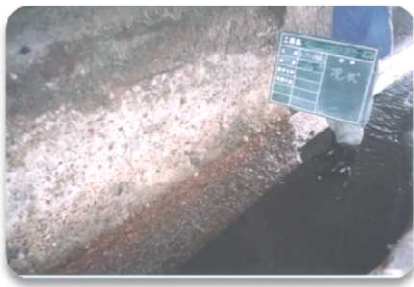
施工前 (劣化状況)
